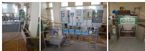
Mikrosíťová filtrace s UV zářením a peroxidem vodíku
